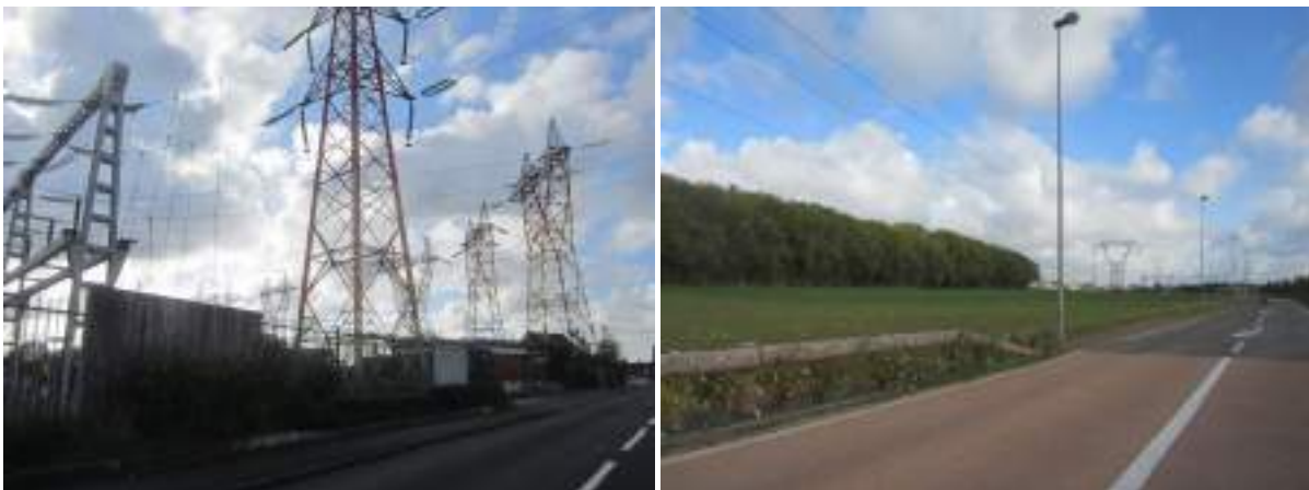
Le poste électrique et un espace cultivé traversé par une ligne électrique
