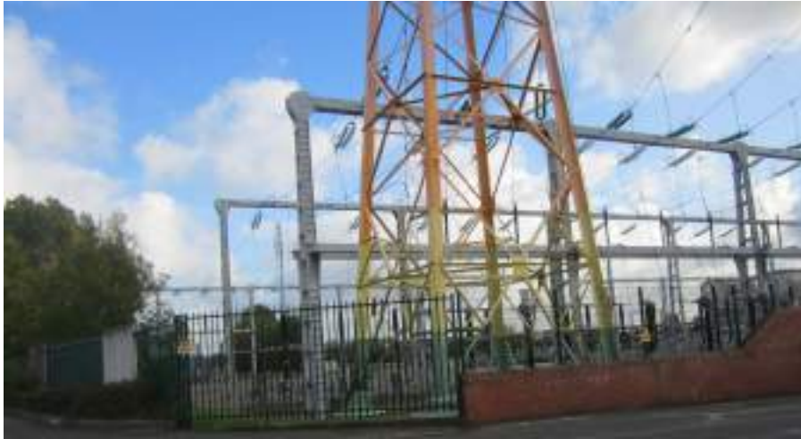
Le poste électrique
